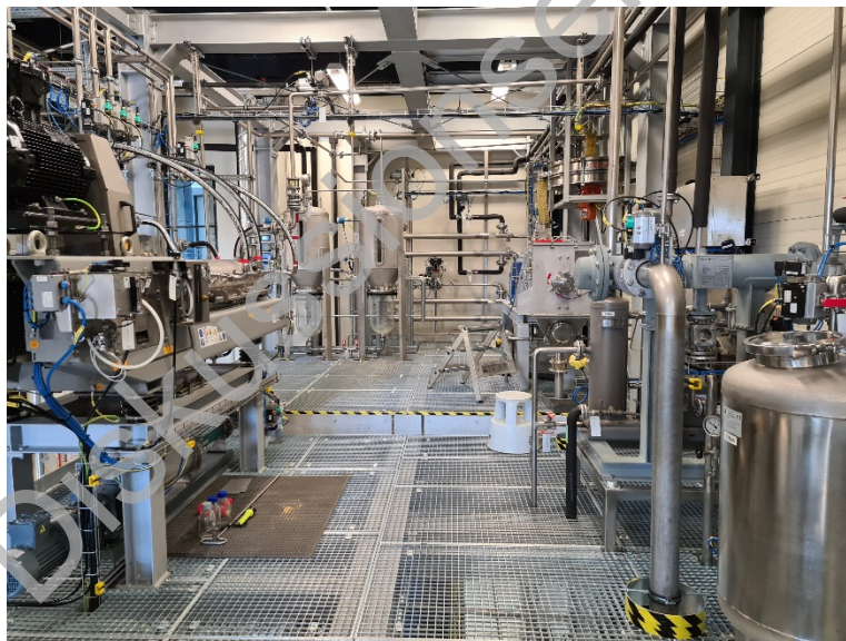
Abb. 6: Pilotanlage zur Aufarbeitung von Rapssaaten (Bildquelle: Fraunhofer CBP)
