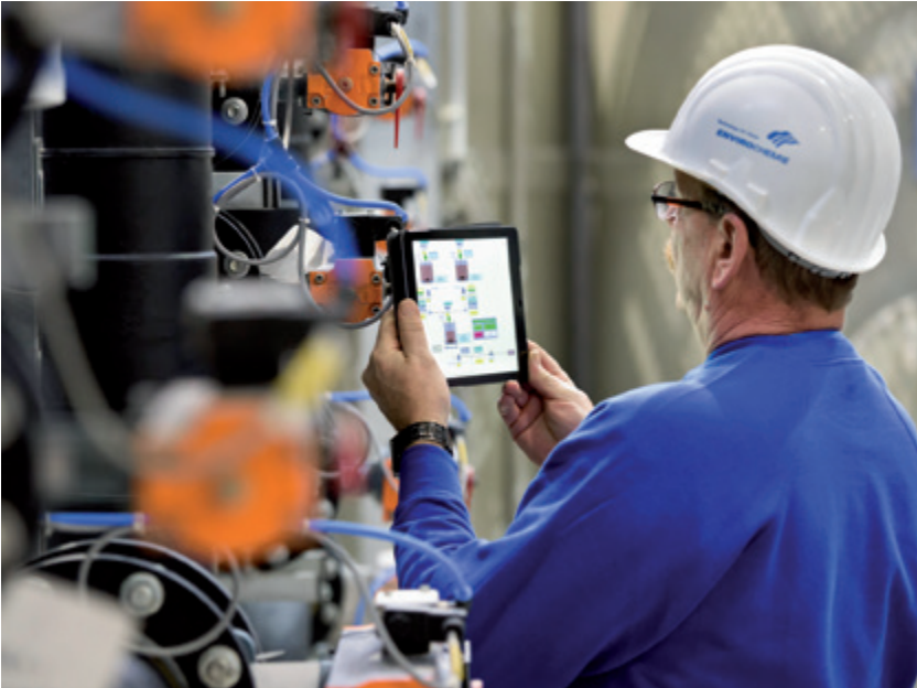
Abb. 5.4: Vor-Ort-Erfassung von Betriebszuständen und Anlagenkonfigurationen
